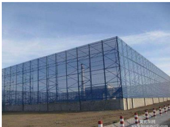
防风抑尘网实例照片
